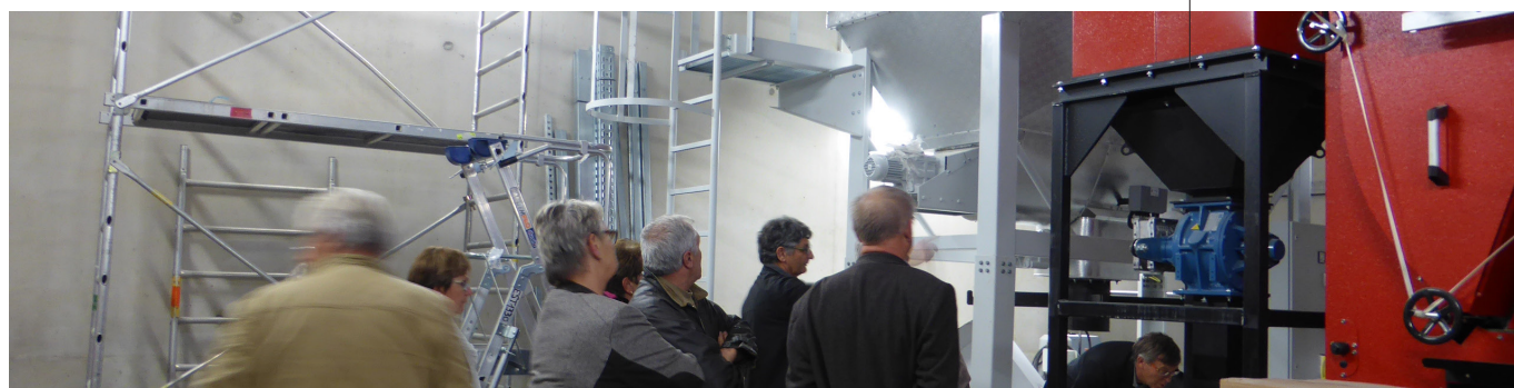
- Chaufferie bois, Le Blanc -
